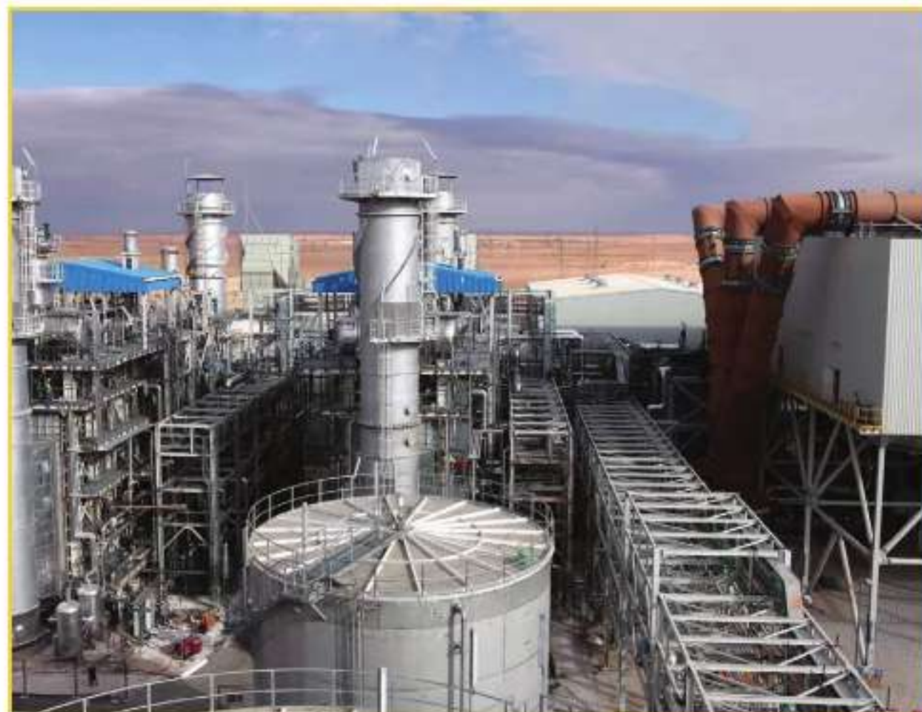
إنشاء محطات للكهرباء في اليمن
