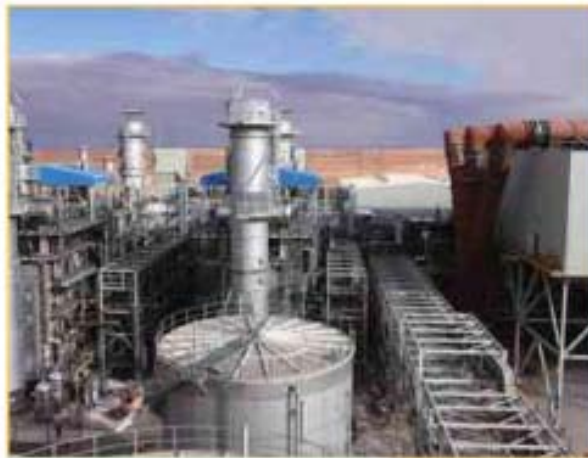
إنشاء محطات للكهرباء في اليمن
